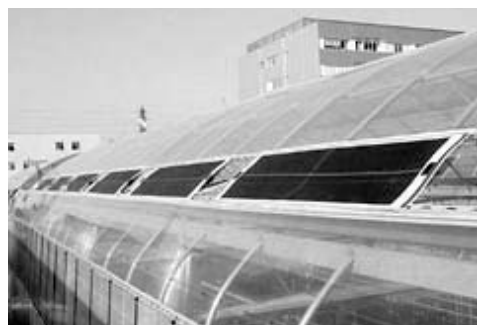
ハウスの屋根に太陽光パネル
