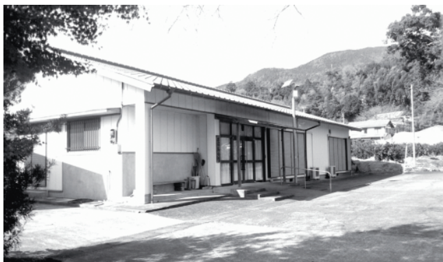
老朽化が進む集会所
