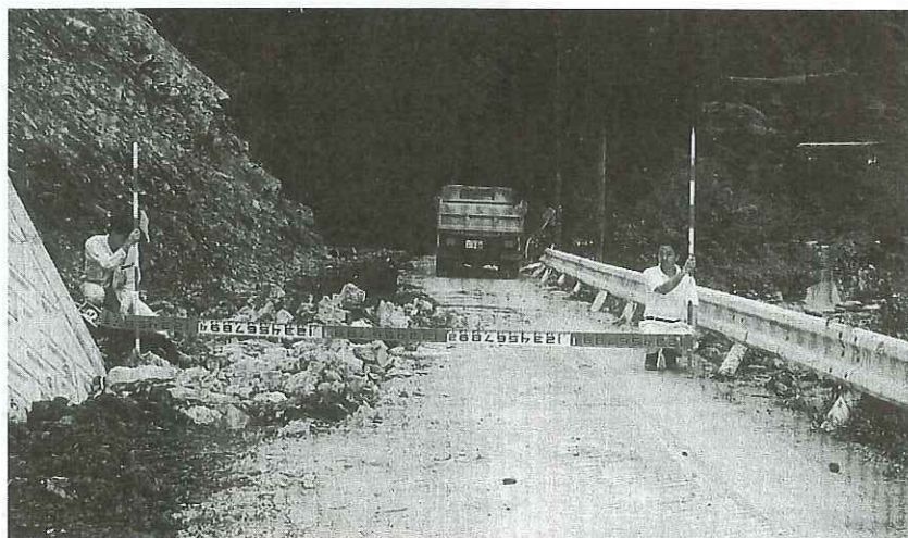
町道与川内中央線の災害状況
