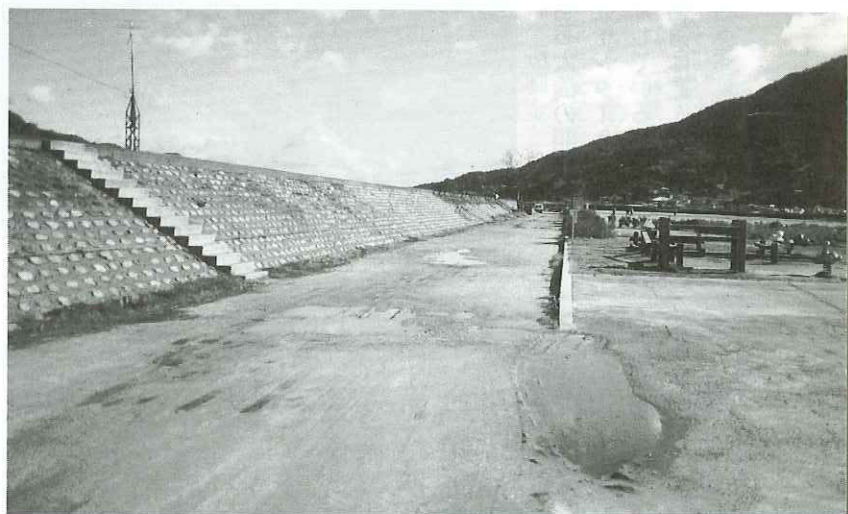
星谷運動公園の道路状況
