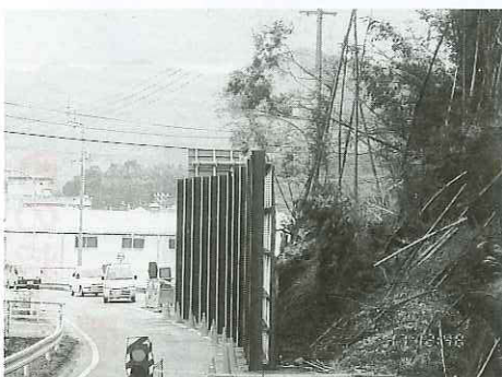
県道三溪バイパスの山崩れ現場
