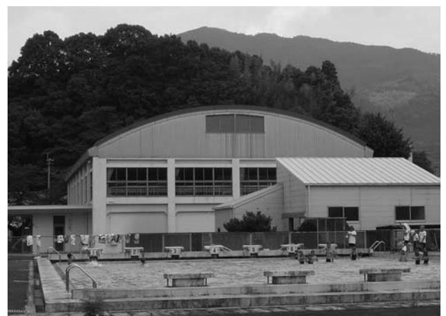
改修工事が必要な横小体育館
