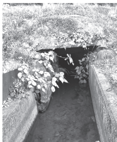
用水路が詰まると大変
