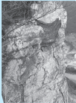
亀裂がいっぱい!!
