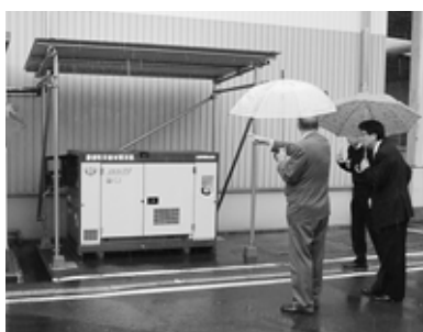
災害対策用発電機
